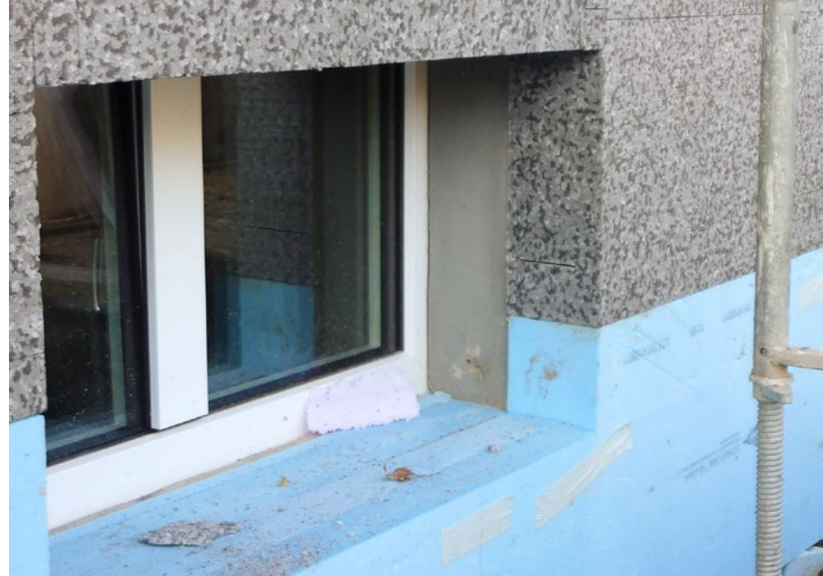
Massive Isolation an der Grünmattstrasse und Aufnahme Wärmebildkamera.
